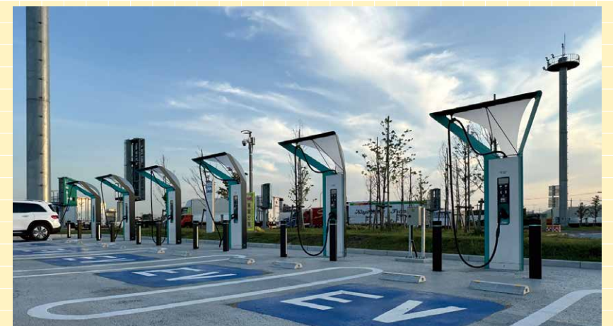
電気自動車用急速充電器 事業主体：東京電力ホールディングス株式会社+株式会社e-Mobility Power+ニチコン株式会社 デザイナー：山中俊治+檜垣万里子+佐藤翔一
