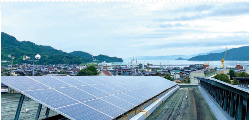
▲太陽光パネル(中島総合文化センター)
